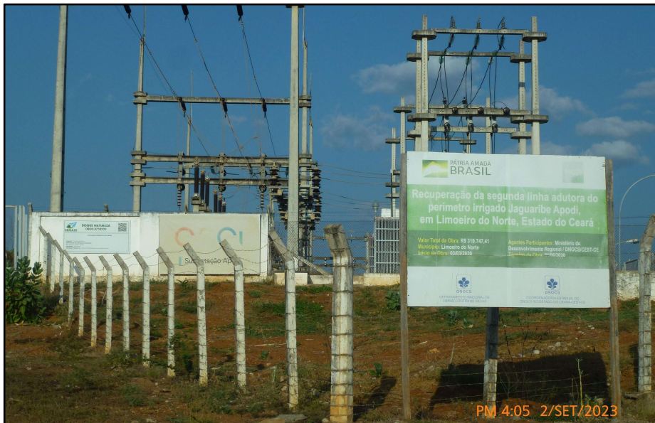
RH5 – Baixo Jaguaribe - Subestação da Estação de Bombeamento do Perímetro Irrigado Jaguaribe-Apodi
