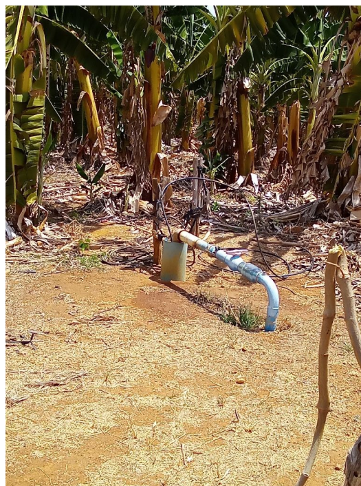
(b) Captação através de poço.
